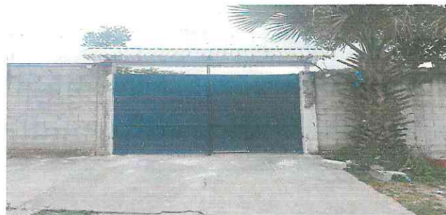
Foto 2: sustitución de porton de metal por metal y capota. FINALIZADO
