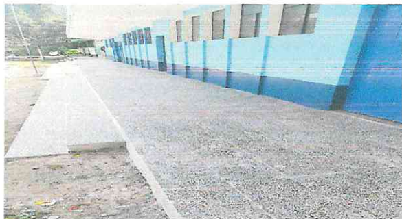
Foto 1: Se sustituirá la torta de cemento por piso de granito en el corredor donde se encuentran las aulas por motivo de deterioro. FINALIZADO
